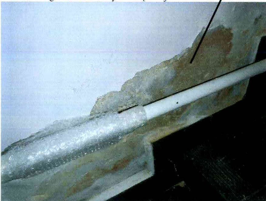
Widok zawilgocenia od strony wewnętrznej
